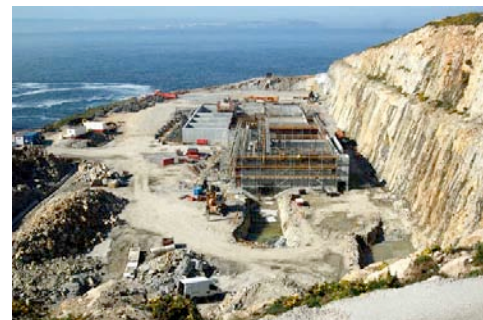
Estado das obras da depuradora de augas residuais (EDAR) de Poriño en Abril
